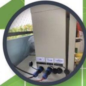
แผงจ่ายสำหรับเสียบโซลินอยด์
